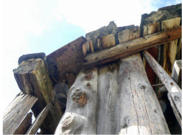
Nordostseite, Zustand Dach (© Castellani Architektur, Andreas Zimmerli, 10.2022)
