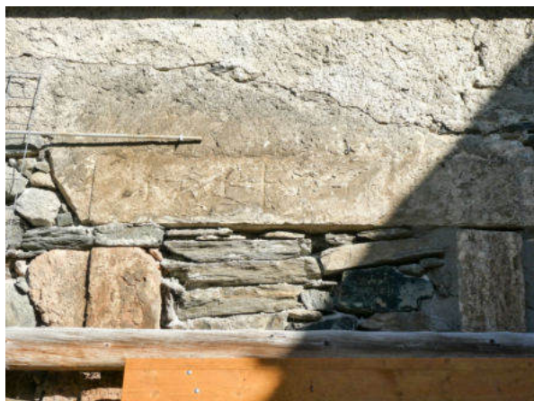
Südseite, Türsturz Kellergeschoss rechts (© Castellani Architektur, Andreas Zimmerli, 10.2022)
