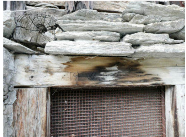
Südostseite, Türsturz Stalleingang (© Castellani Architektur, Andreas Zimmerli, 09.2022)
