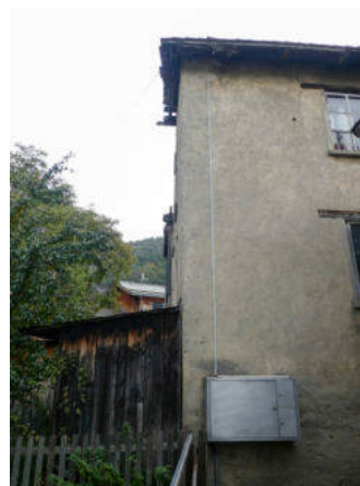
Nordwestansicht, Zustand Dach (© Castellani Architektur, Andreas Zimmerli, 10.2022)
