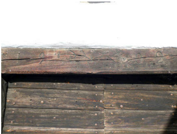
Südseite, Türsturz Kellereingang (© Castellani Architektur, Andreas Zimmerli, 10.2022)
