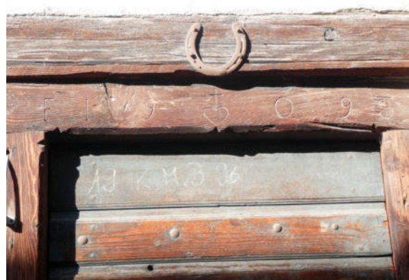
Ostseite, Türsturz unteres Wohngeschoss (© Castellani Architektur, Andreas Zimmerli, 10.2022)
