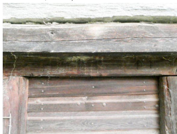
Westseite, Türsturz Saalgeschoss (© Castellani Architektur, Andreas Zimmerli, 10.2022)
